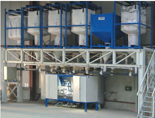
▲ COM 70-3 Granulatdosieranlage mit drei Zwischenbehältern für 6 Farben in 3 Mischer mit einem elektronischen Wiegebehälter
